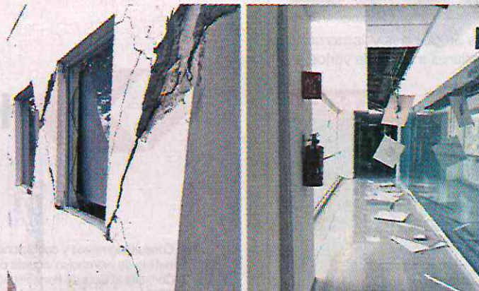
El Hospital Puerta de Hierro, en Colima, registró afectaciones en su estructura y acabados, debido al movimiento telúrico.
