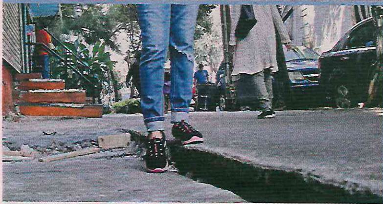
■ Habitantes de la Colonia Doctores señalaron los daños.
