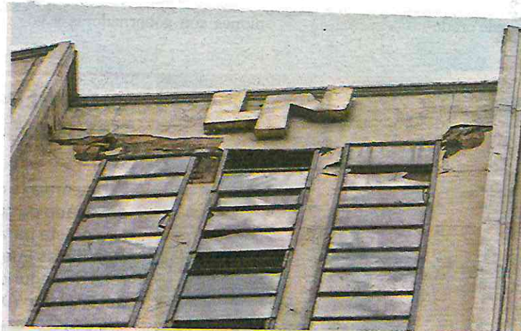
Afectaciones en el edificio de la Lotería Nacional
