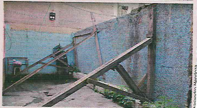
Desde hace 10 años, la barda de Dr. Navarro 182 está apuntalada, mientras el edificio contiguo está en riesgo de colapso.
