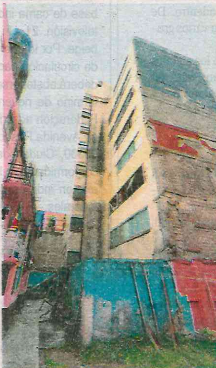
Esta es la barda dañada en Doctores
