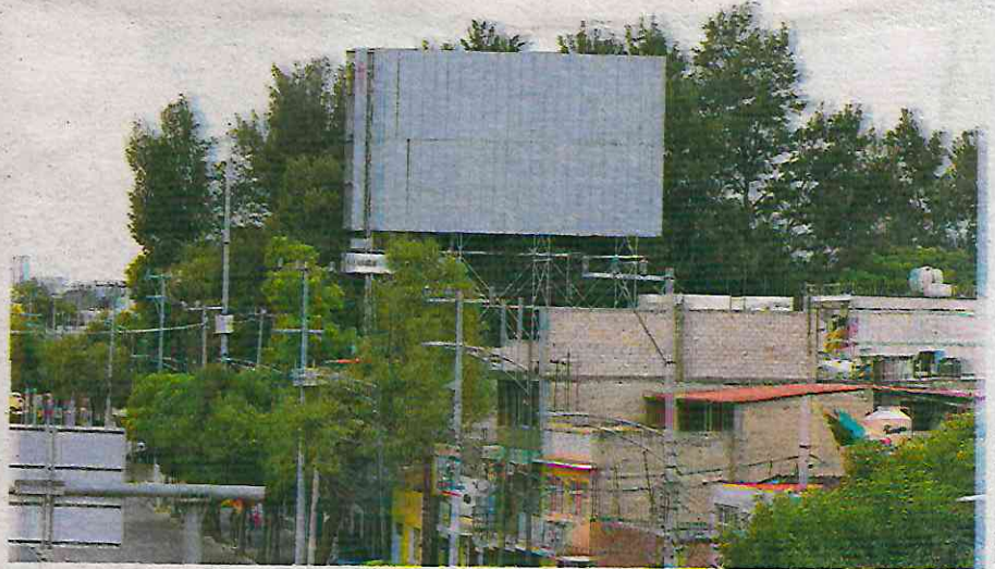
La estructura metálica de los espectaculares puede aumentar el peso de una construcción entre 2 y 10 toneladas /IGNACIO HUIZIL
