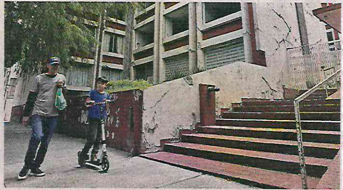
■ Fisuras en el inmueble y en las posturas de los residentes.
