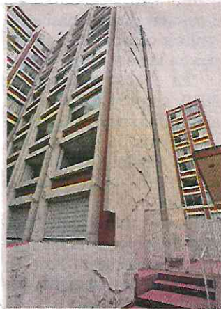
■ La demolición o el reforzamiento están detenidos.
