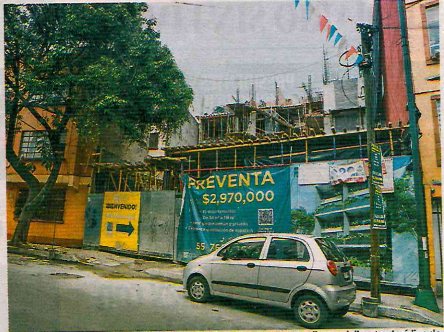
PELIGRO. Las obras de Francisco Murguía 86, por las que suspendieron al director Jurídico de la MH, son catalogadas de alto riesgo debido a que existe una saturación de agua en un talud.
