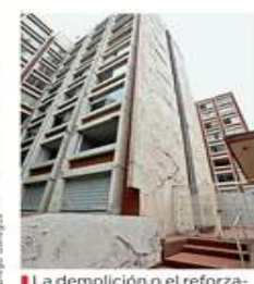
La demolición o el reforzamiento están detenidos.
