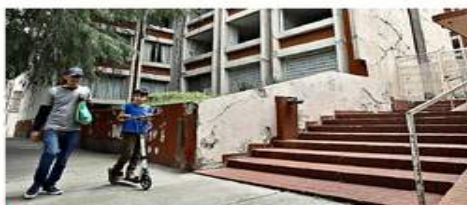
Fisuras en el inmueble y en las posturas de los residentes.
