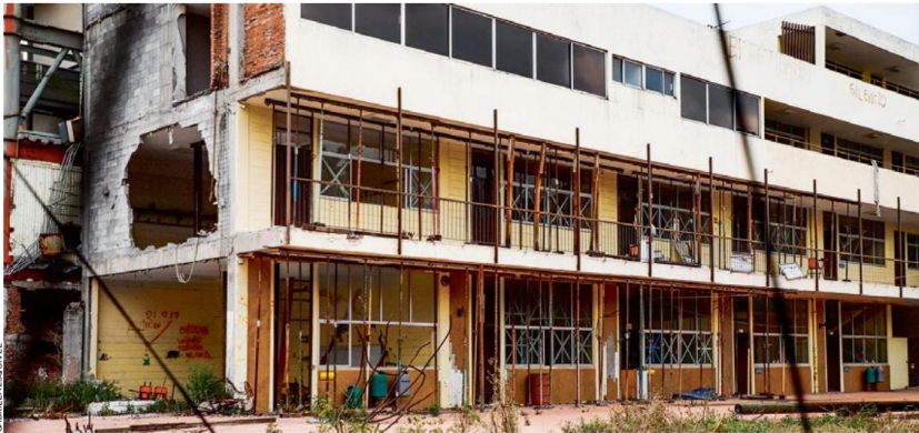
VESTIGIOS EN PIE. A cinco años, los restos del Rébsamen continúan de pie, pues no se ha querido proceder con su demolición hasta que se haga justicia.
