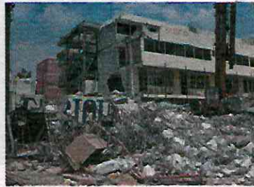
DERRUMBE. El colegio Enrique Rébsamen, en la CDMX, tras el 19-S.
