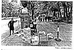
En la primera etapa de la intervención de monumentos se realizaron pruebas con diferentes productos y técnicas de rehabilitación.
