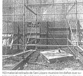
El material retirado de San Lázaro muestra los daños que sufrió con la lluvia. Servirá como parte de las pruebas en el juicio.
