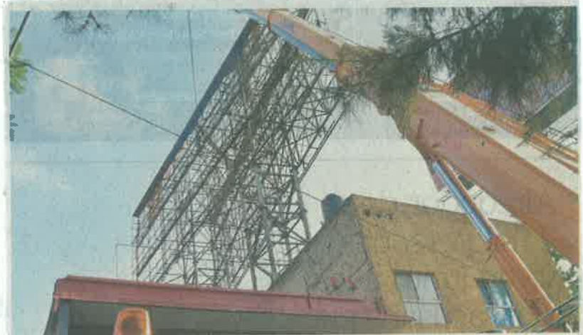
Los trabajos para quitar la estructura, de 30 metros de longitud, 17 de altura y 25 años de antigüedad, iniciaron el viernes en punto de las 22:00 horas.
