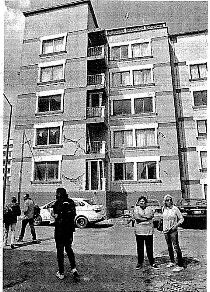
En Xochimilco, los daños continúan a la vista después de casi dos años de que se registró el sismo.
