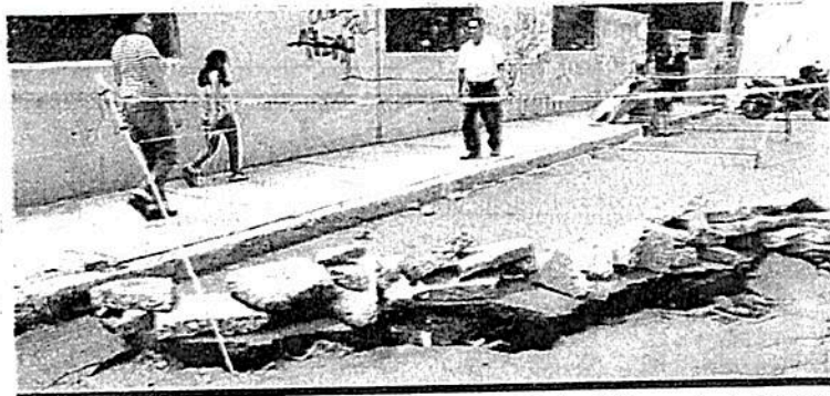
Con la temporada de lluvias una de las grietas en la colonia del Mar, en la alcaldía Tláhuac, se ha notado más y las autoridades no dan respuesta a la queja de los vecinos.
