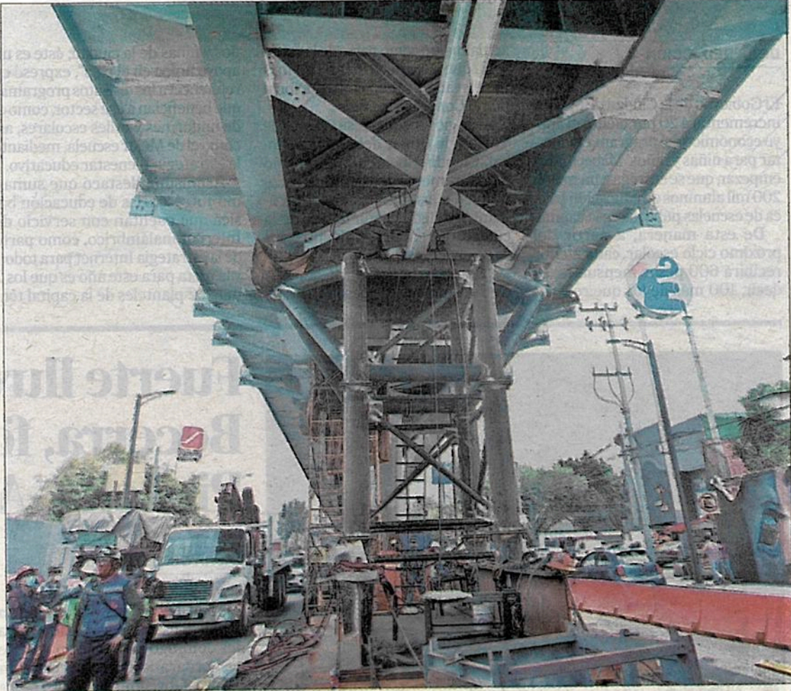
► Aspecto de los trabajos de reforzamiento y rehabilitación del viaducto elevado de la línea 12 del Metro. La imagen corresponde a una visita de supervisión del secretario de Obras, Jesús Esteva, y el director del STC, Guillermo Calderón. Foto Guillermo Sologuren
