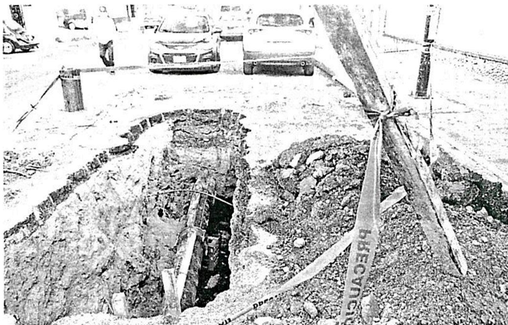
CON TINO. Aunque falta el relleno, la reparación que se hizo el sábado ya evitó inundaciones en la casa de Francisco Ortiz.
