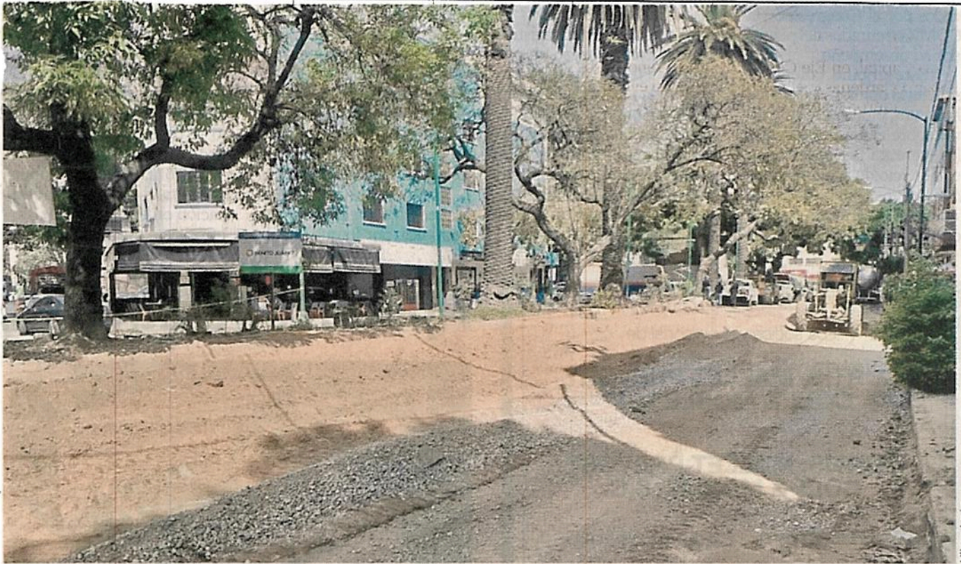
La Avenida Diagonal de San Antonio es reasfaltada, pero los trabajos han sido suspendidos desde hace semanas.
