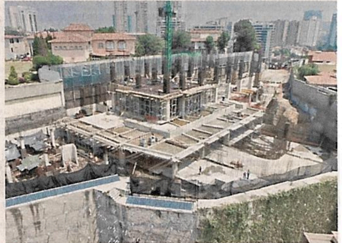
El desarrollo ubicado en Paseo de los Laureles 278, en Bosques de las Lomas, perdió las licencias de construcción.
