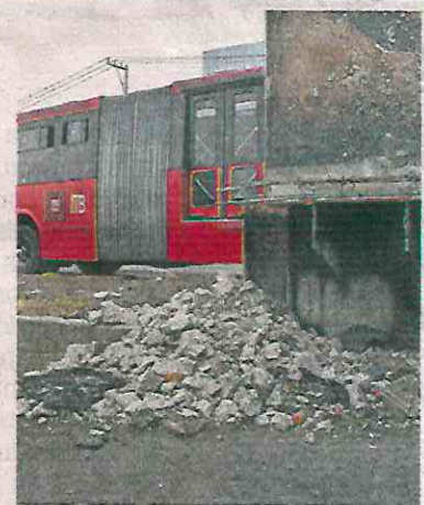
En febrero, un tráiler se impactó contra un muro de la estación.
