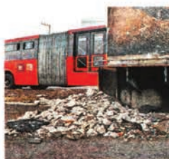
En febrero, un tráiler se impactó contra un muro de la estación.
