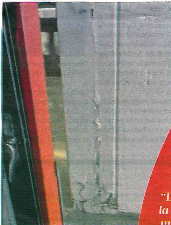
Grietas y fisuras en los elementos estructurales e instalaciones
