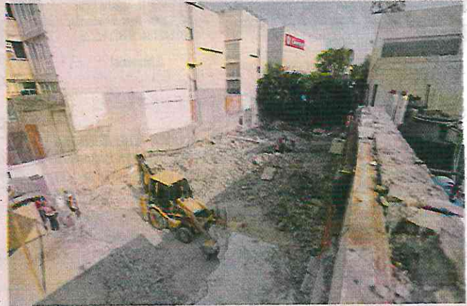
En la zona donde se realiza la construcción se registraron daños durante los sismos de 1985 y 2017.
