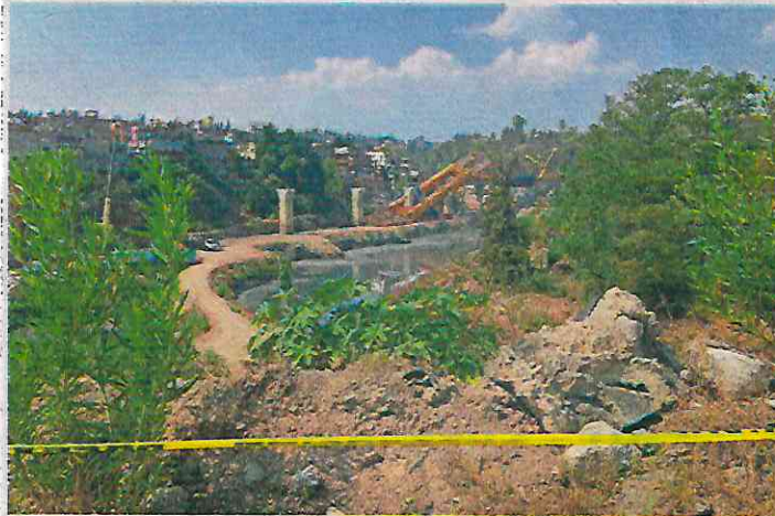
Tras la caída de la lanzadora de dovelas, expertos toman medidas para retirar la maquinaria.
