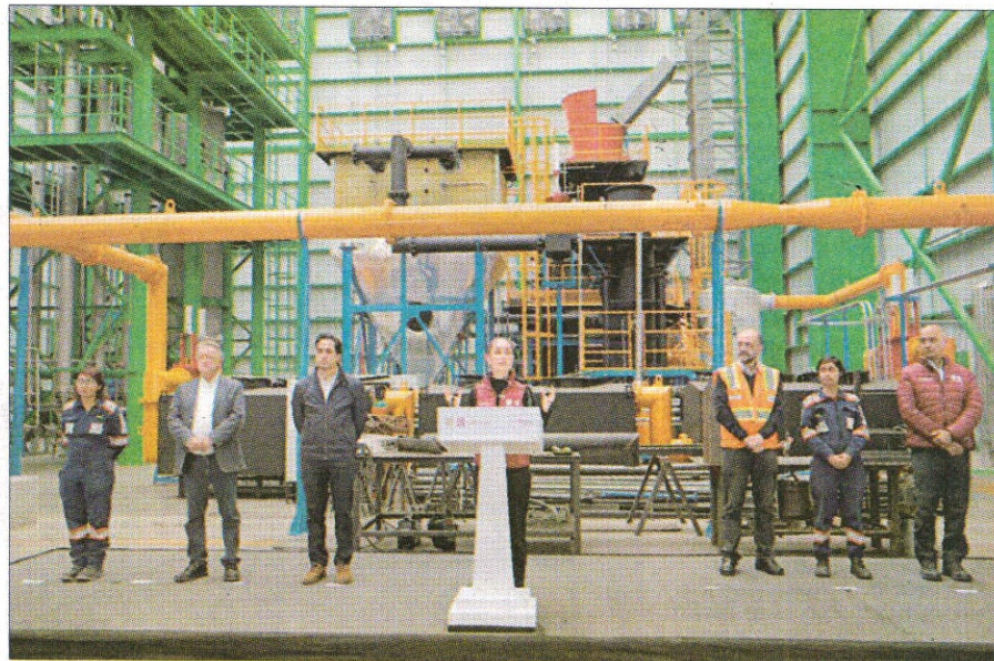
▲ La jefa de Gobierno, Claudia Sheinbaum, recorrió la planta de carbonización hidrotermal ubicada en el Bordo Poniente, la cual tendrá capacidad para procesar, en una primera etapa,
