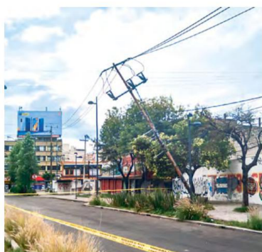
PELIGRO. Alas afueras del Metro La Viga, en Venustiano Carranza, un poste quedó colgando tras la ventisca.
