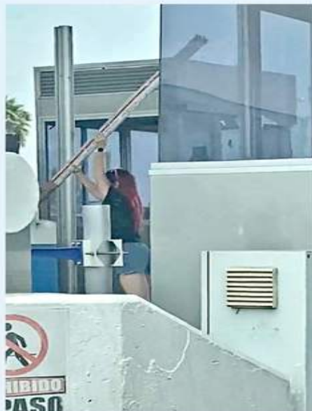
La falla en el sistema de cobro a distancia provocó ayer largas filas de autos en la caseta de cobro de Tepotzotlán, en la Autopista México-Querétaro. Algunos usuarios levantaron las plumas para cruzar.
