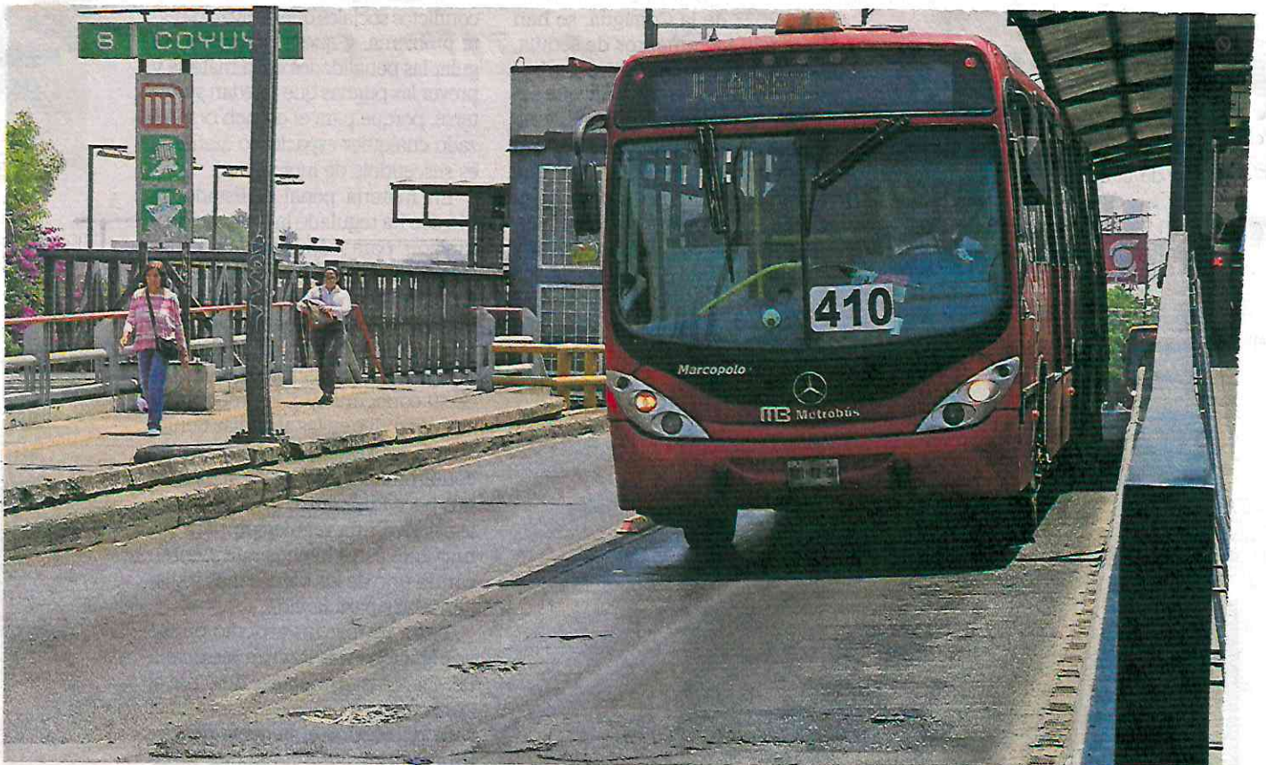
El Metrobús explicó que se tienen identificados 10 puntos con daños en la Línea 2, que corre de Tepalcates a Tacubaya.
