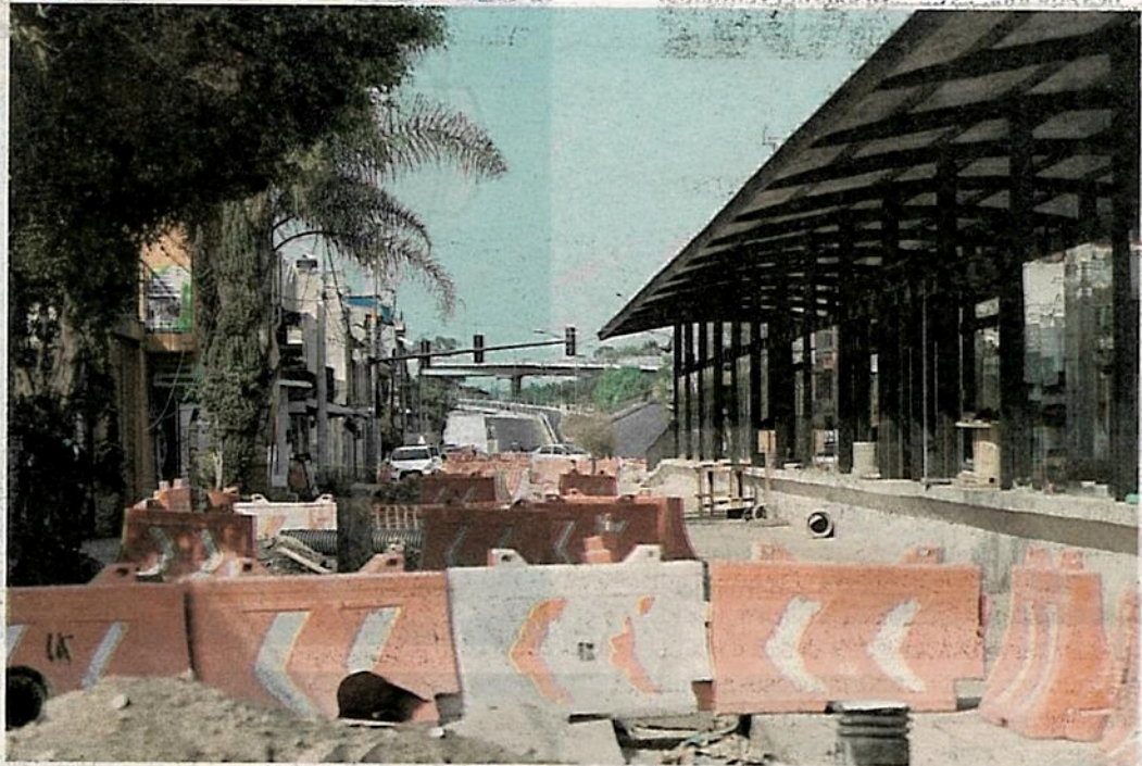
Así lucen los trabajos en la estación Muyuguarda, aún hay obra vial / FOTOS: DANIEL GALEANA
