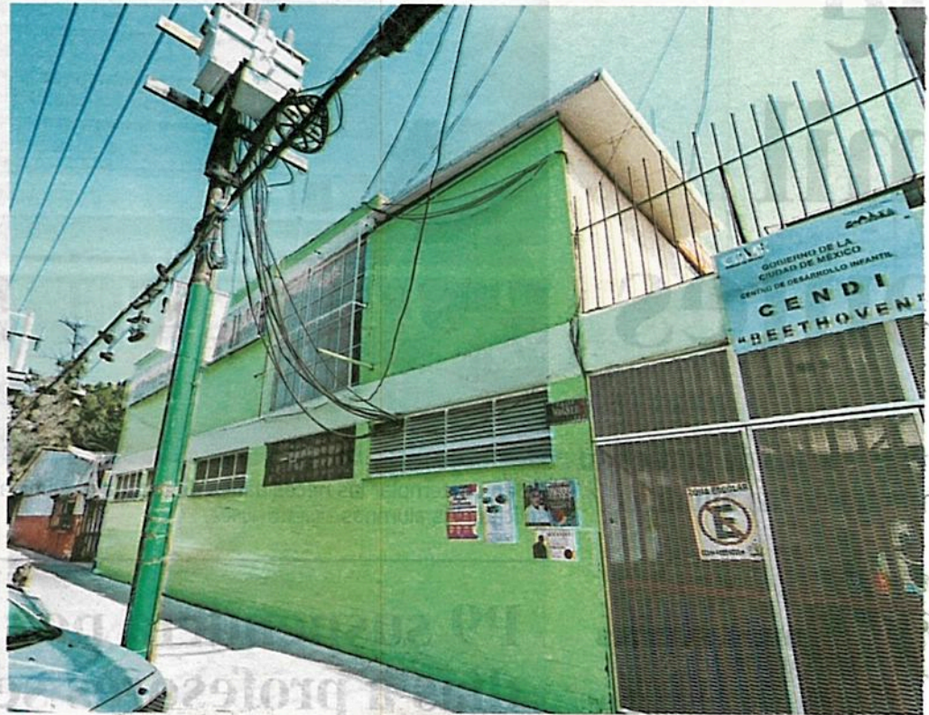
Recibe un tendido desde un transformador ubicado en la calle Wagner/ROBERTO HERNÁNDEZ
