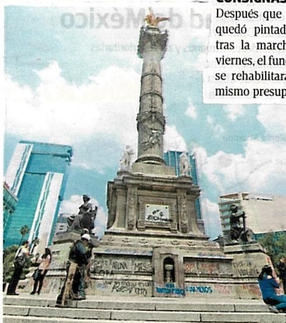
Este monumento tendrá reparaciones por daños en su columna y por graffiti/ROBERTO HERNÁNDEZ
