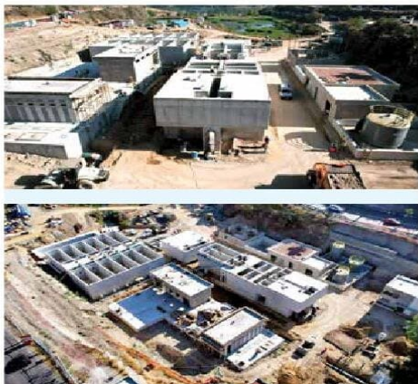
La Planta Potabilizadora Madín II es parte de la infraestructura desarrollada de manera tripartita.
