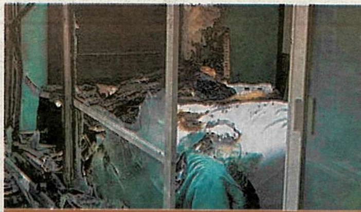
Así quedó uno de los departamentos vecinos tras el incendio.
