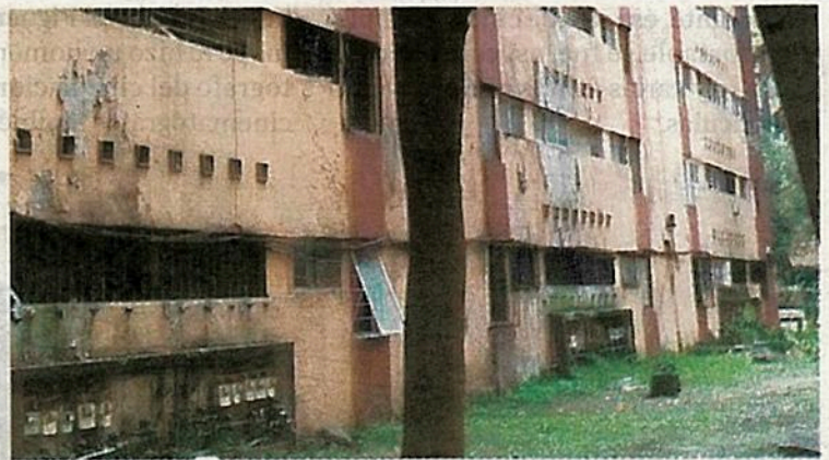
Sus edificios están muy deteriorados
