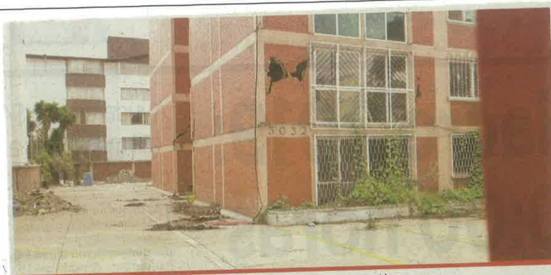
En la avenida Canal de Miramontes, en Coyoacán, hay edificios que no han sido intervenidos.
