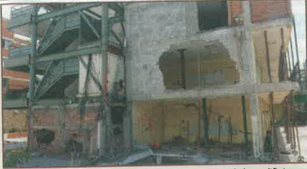
Con apuntalamientos se mantiene en pie uno de los edificios.
