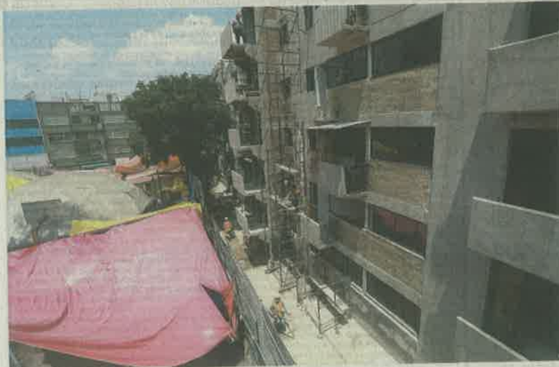
De acuerdo con la Comisión para la Reconstrucción, en las nueve torres ya concluyeron los trabajos de seguridad estructural.
