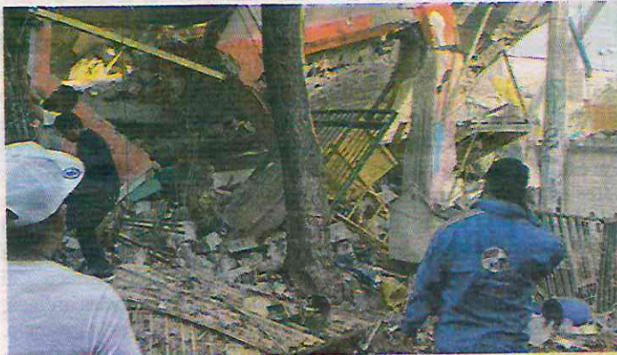
Servicios de emergencia laboraron en el lugar, aunque desde que ocurrió la explosión, vecinos ayudaron a retirar los escombros del inmueble que quedó destruido en su totalidad.
