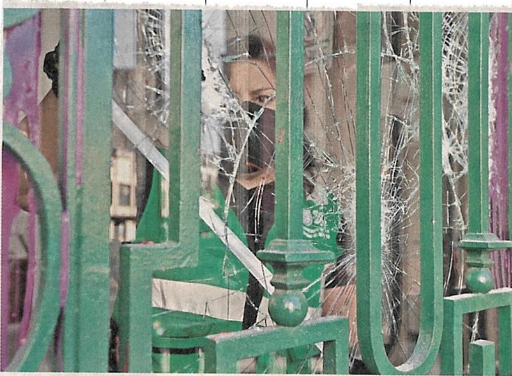
■ Los daños sólo fueron en la fachada, escalinatas, puertas y escalinatas del Congreso.
