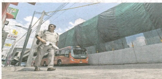
La jefa de Gobierno anunció que el tramo gemelo de L12 se tiene que demoler y reconstruir. Actualmente está cubierto por una lona verde.
