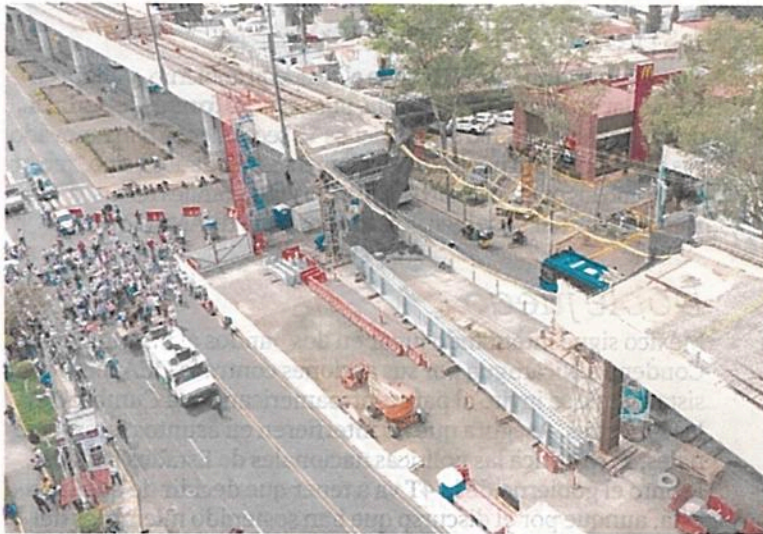
EL SITIO. El tramo gemelo está a unos 200 metros del sitio del colapso.
