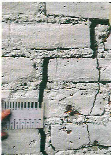
GRIETA reflejada en estructura después del sismo del 14 de diciembre del 2023.
