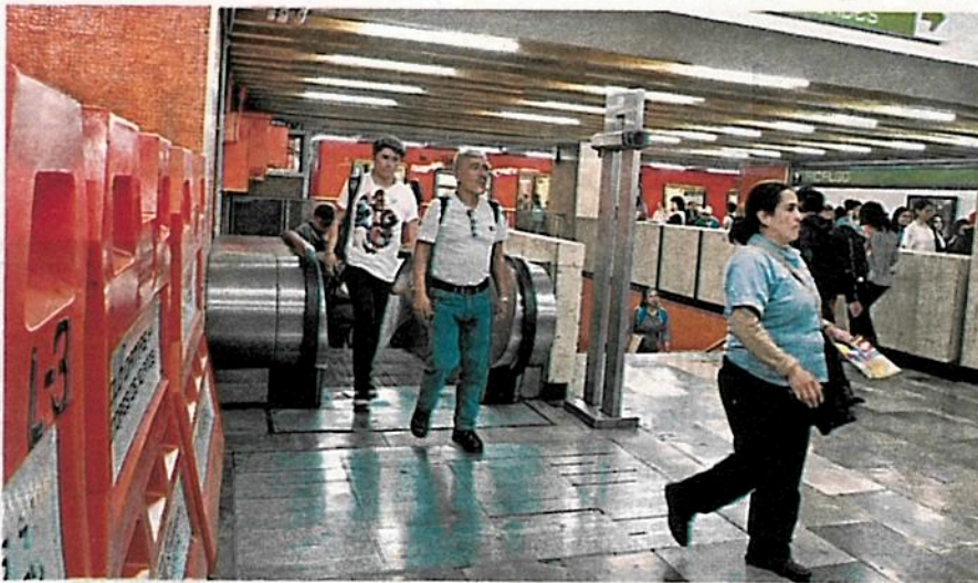
Orines y carga excesiva han dañado al sistema de escaleras/LAURA LOVERA
