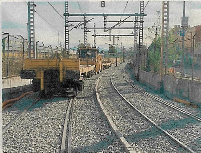
La rehabilitación del Tren Ligero comenzó el 1 de julio pasado; las obras incluyeron ajuste de trazo, cambio de vías y remodelación de estaciones.
