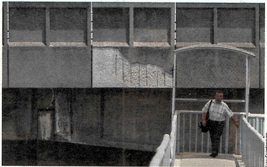
TRAS EL ACCIDENTE en la Línea 12 del Metro, se revisó la estructura en Pantitlán.
