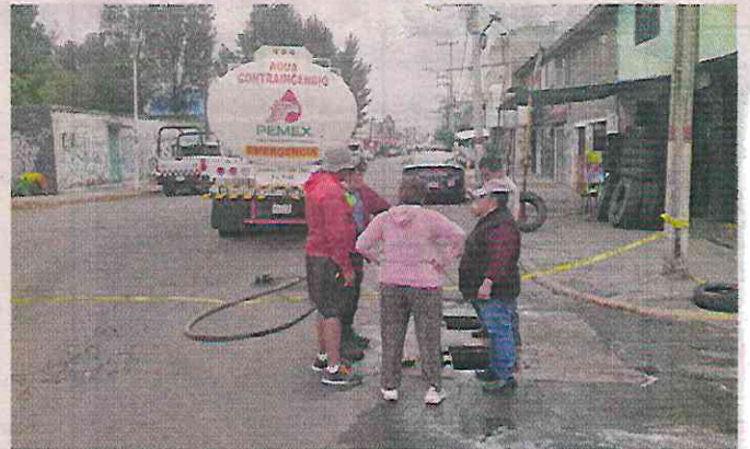
Según los vecinos, había una capa de aceite con olor a gasolina sobre una válvula de paso del agua potable.
