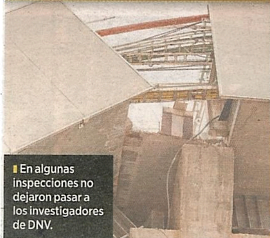
■ Cada grieta o hundimiento en el tramo elevado debía ser inspeccionada.
