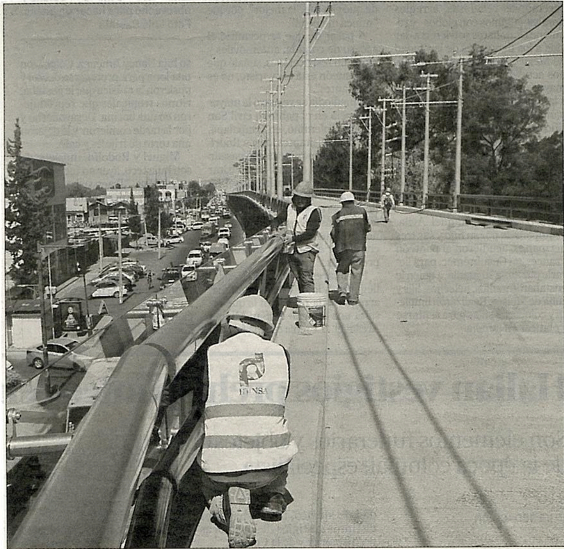
▲ La jefa de Gobierno de la Ciudad de México, Claudia Sheinbaum Pardo, realizó un recorrido de supervisión de los trabajos de construcción del
