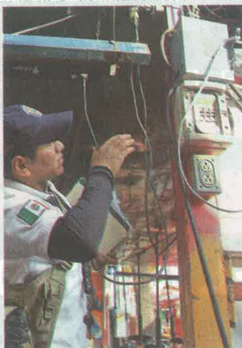
Para que funcionen los juegos mecánicos se roban la luz y sus instalaciones son peligrosas.
