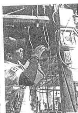
Para que funcionen los juegos mecánicos se roban la luz y sus instalaciones son peligrosas.
