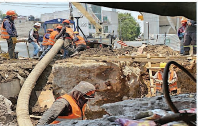
FIGURA. Los trabajos de perforación para la obra del Tren provocaron que una tubería resultara dañada en la Alcaldía Alvaro Obregón.
