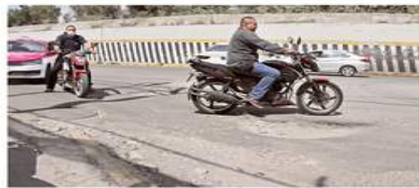
Conductores tienen que esquivarlos para evitar caer y así tener un accidente o que sus vehículos tengan que ser reparados.
