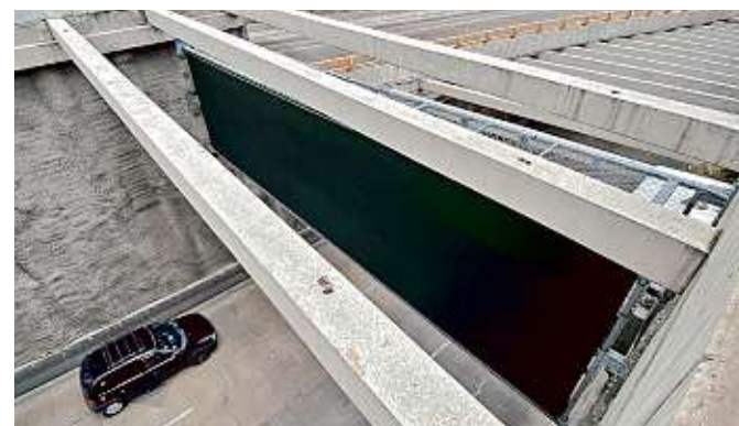
■ Las trabes estructurales soportan las pantallas electrónicas.
