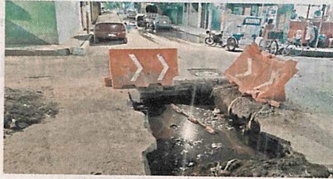
■ Vecinos señalaron que las aguas negras estancadas provocan un mal olor en la zona.
