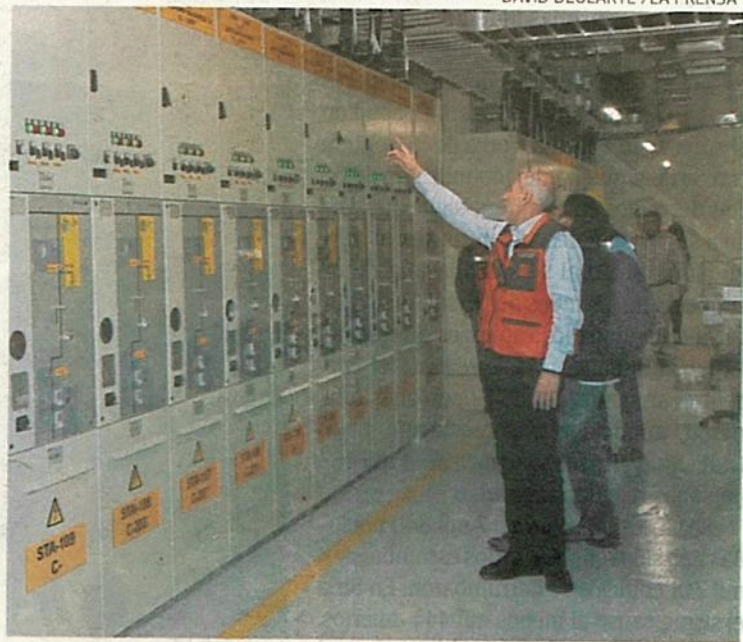
La nueva subestación, según Calderón, extiende la vida del Metro
