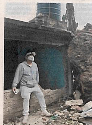
Juan Mora muestra los daños en su casa.
