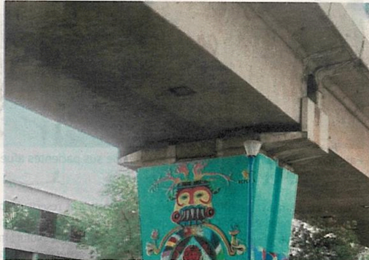
De acuerdo con una auditoría de 2018, se señala que tampoco en 2017 hubo mantenimiento completo /FOTO: JOSÉ MELTON
