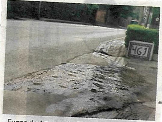
Fugas de Agua en la CDMX
