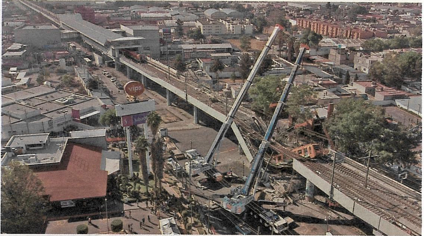
Dos grúas fueron utilizadas para remover los dos vagones que cayeron tras el colapso de la estructura. EFE
