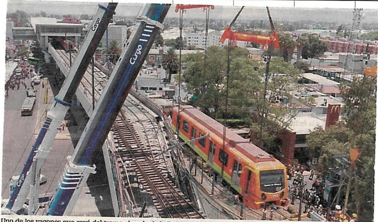
Uno de los vagones que cayó del tramo elevado de la llamada Línea Dorada fue removido con dos enormes grúas para trasladarlo a los talleres del Metro. Autoridades cercaron el perímetro para evitar más accidentes.
