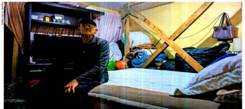
Habitantes de Minas de Cristo aseguran que el riesgo de colapso se incrementa tras los microsismos recientes en Alvaro Obregón.
