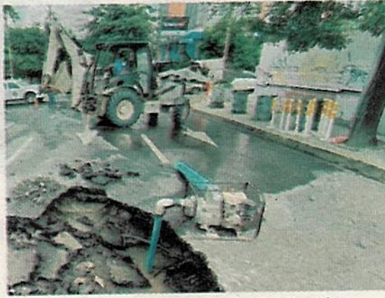
Falta inversión en las redes de distribución
